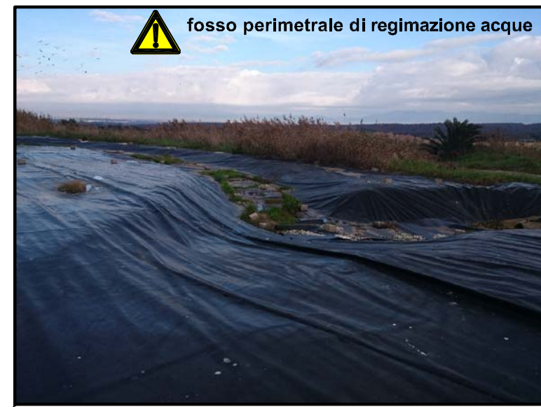
fosso perimetrale di regolazione acque
