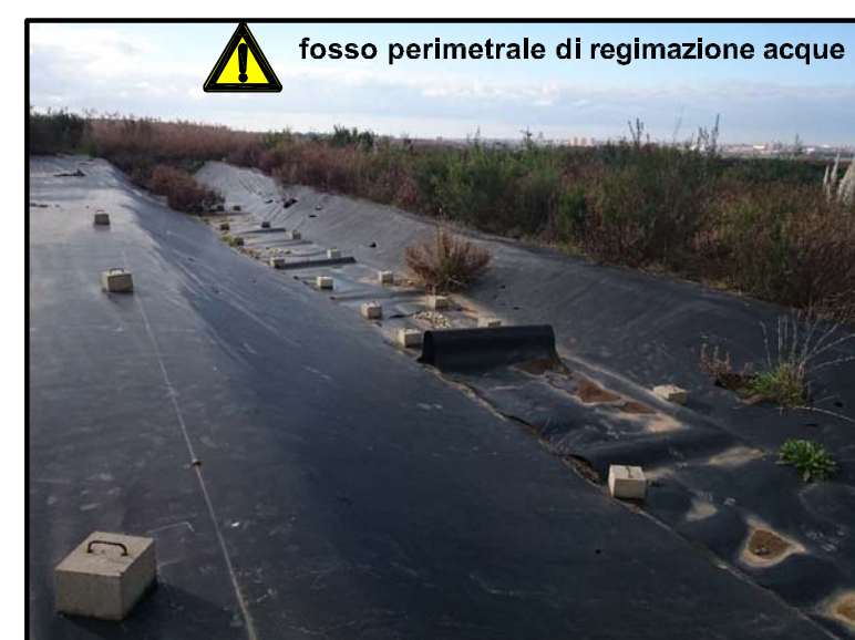
fosso perimetrale di regolazione acque
