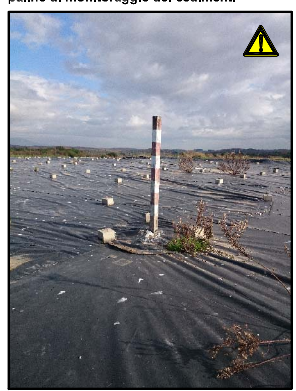
Zona F: sarà necessario porre attenzione alle palline di monitoraggio dei cedimenti
