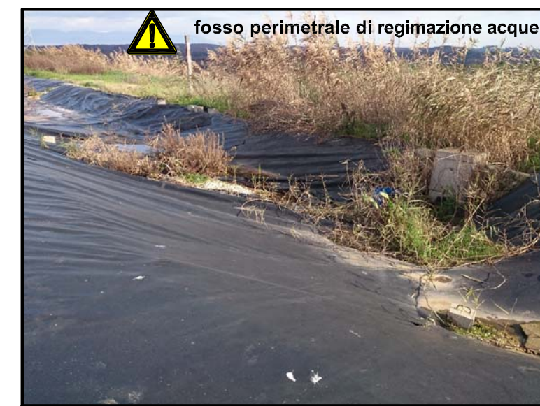
fosso perimetrale di regolazione acque
