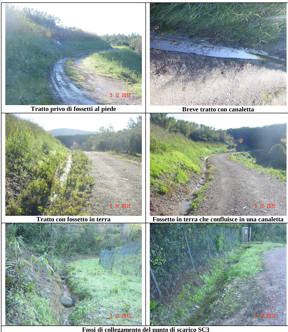
Foto 1 – Fosse al piede e punti di scarico delle acque
